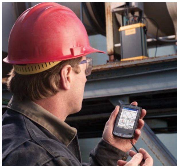
在记录过程中使用 FLuke 1750 电能记录仪的无线 PDA 功能来查看数据。
