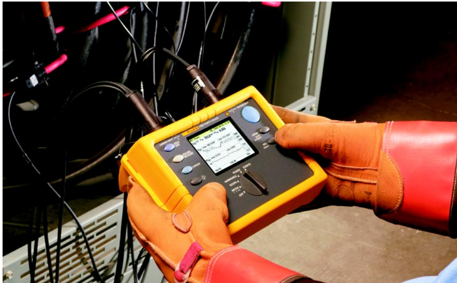
在电力进线处连接一台 Fluke 1735 电能记录仪，以进行为期 30 天的负载研究。
